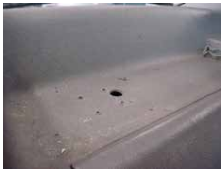
Niet acceptabel (doorvoergaten voor kabels)
